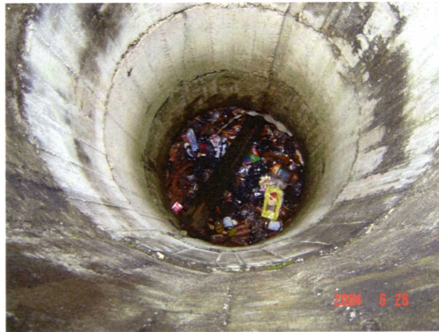
(政府支給の井戸。底にごく浅くしか水がなく、到底使用に耐えない様子がよくわかる)
