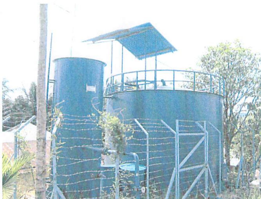
⑮ 貯水タンク
